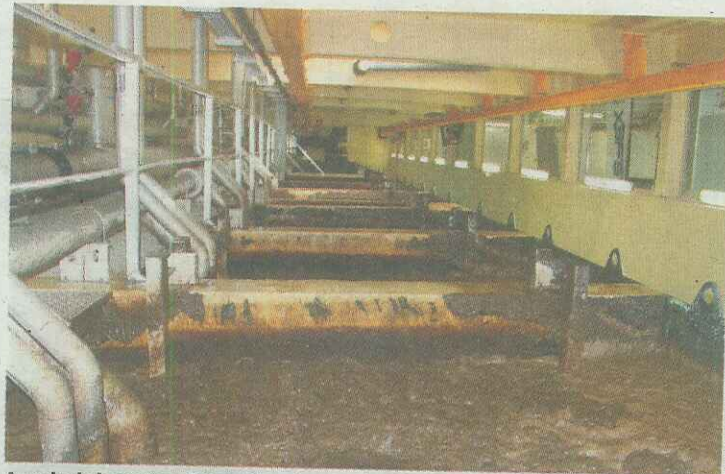
Au sein de la station d'épuration rénovée de Saint-Laurent-du-Var, eaux et boues sont dissociées via des bassins de séparation membranaires.
